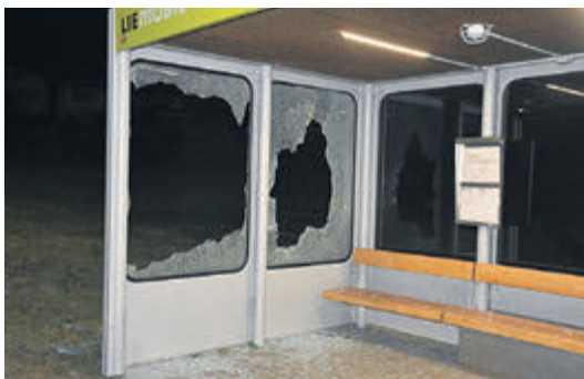
Beschädigte Bushaltestelle Feldstrasse. Bilder: lpfl
