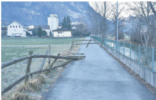
Beschädigter Zaun Kanalstrasse.
